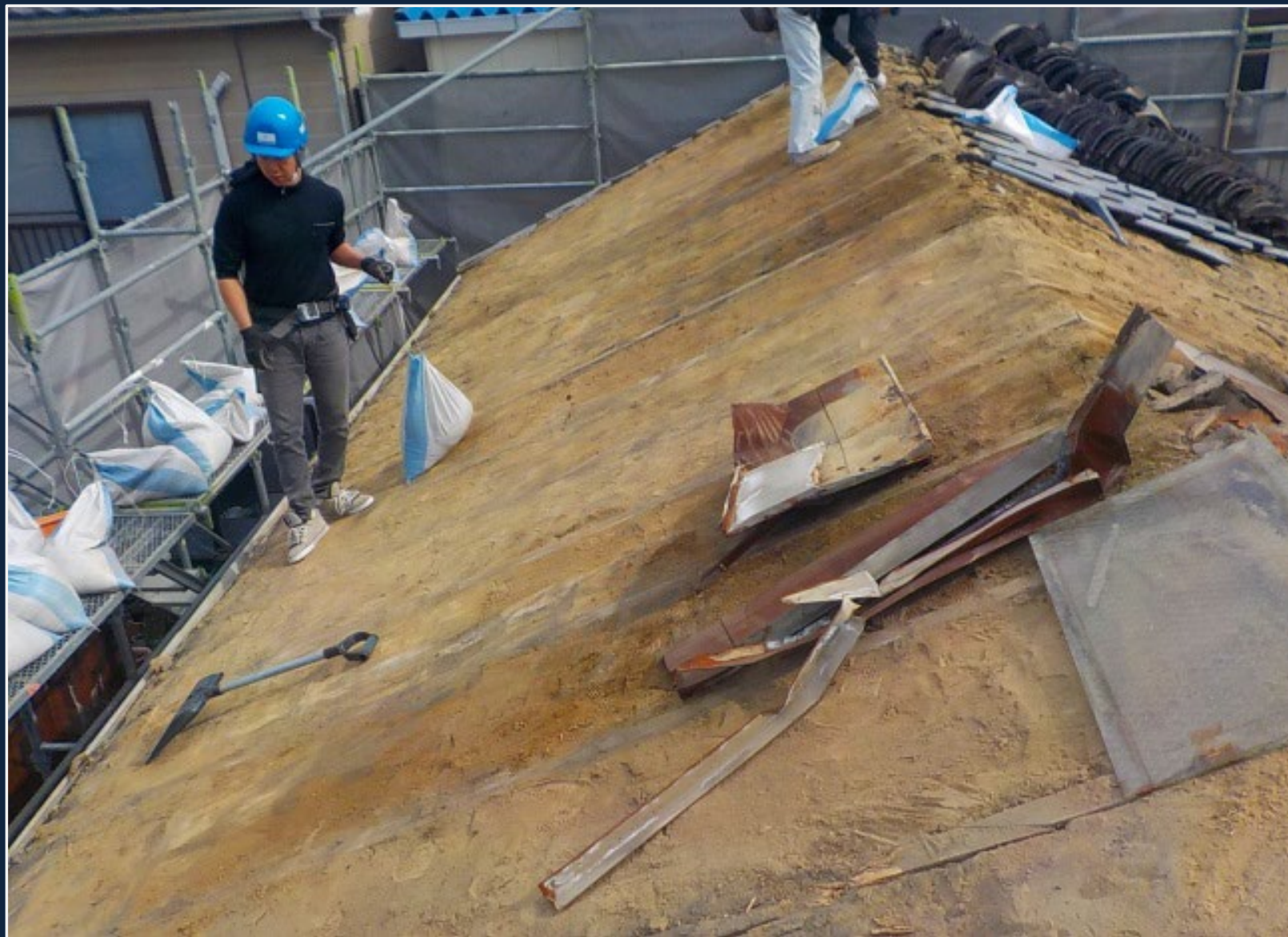
屋根材の撤去後の写真 屋根の下地もぼろぼろの状態です。
